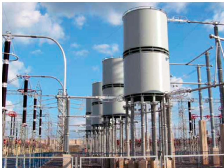
Reactor de Filtro con Núcleo de Aire
